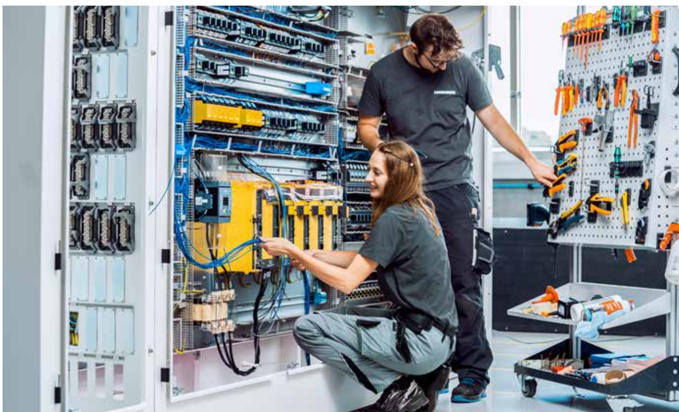
Mechatroniker:innen bei der Arbeit an Schaltschränken.
